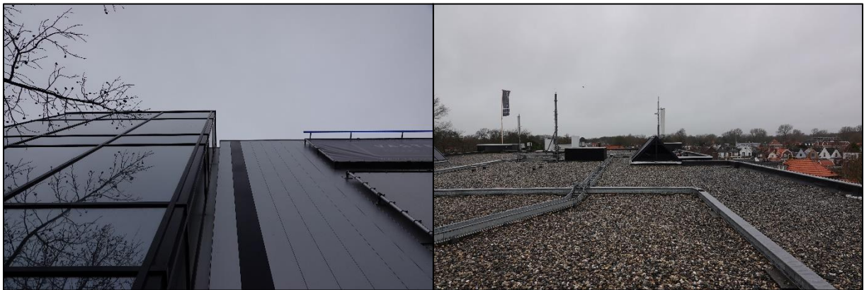
Muren grotendeels van staal en veel grote ramen (links) en een plat dak met een laag grind (rechts).
