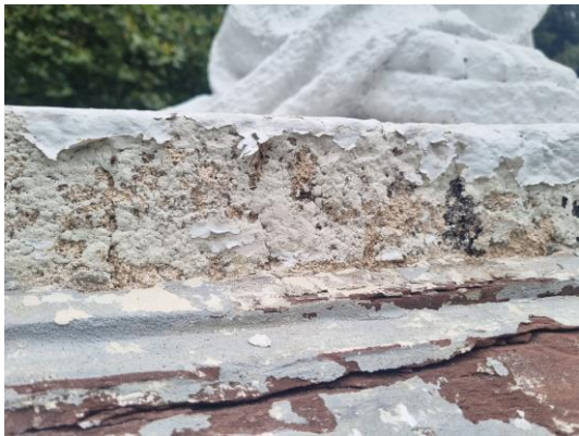
Heel duidelijk is hier de schade in het zandsteen zichtbaar door vochttransport ontstaan.
